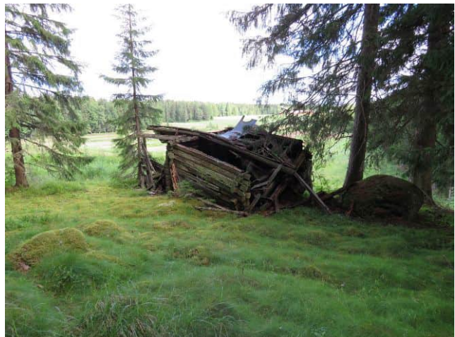
Romahtanut lato pellon reunassa, kuva pohjoiseen.
