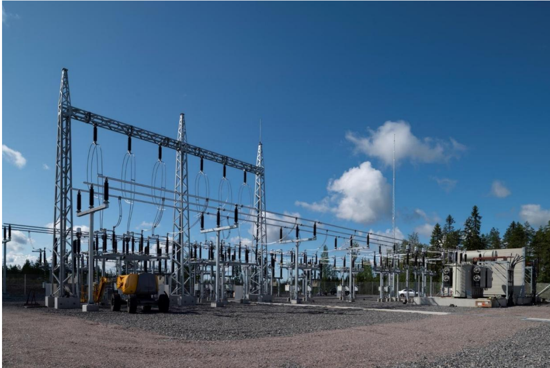
Kuva 5-5. Esimerkki tuulivoimahankkeen sähköasemasta. © Ilmatar Energy Oy.
