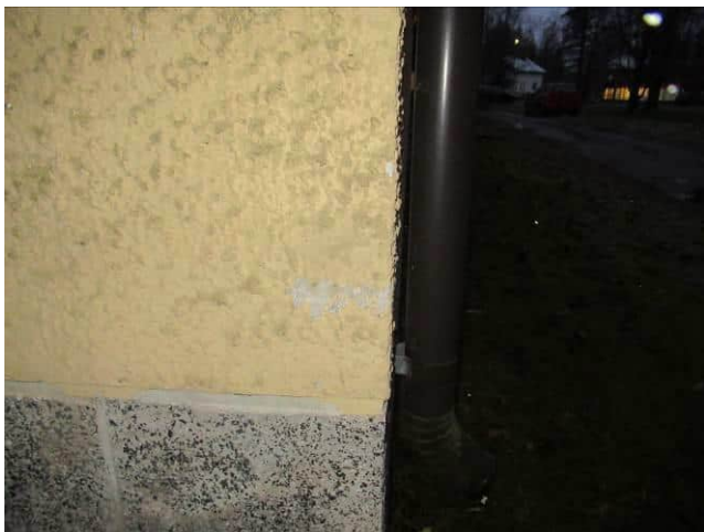
Kuva 6.17 Vaurioita rappauspinnassa rakennuksen nurkassa.
