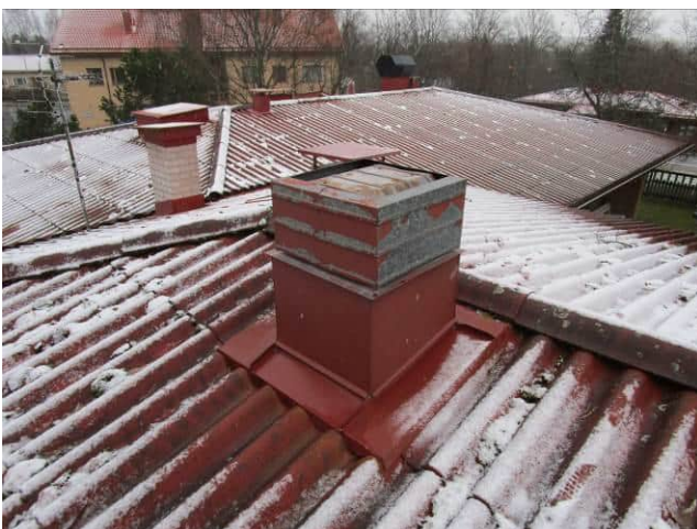
Kuva 6.59 Alkuperäinen huippuimuri, joka palvelee eläinlääkäritaloa
