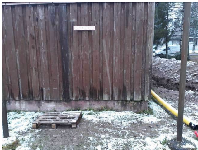
Kuva 6.21 Puuverhous on huonokuntoinen.
