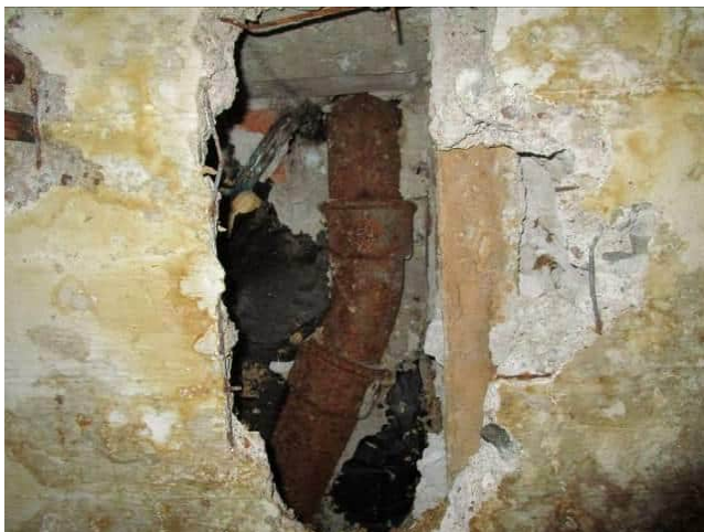
Kuva 6.66 Vaurioitunut jätevesiviemäri välipohjassa, joka vuotaa.
