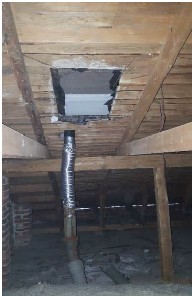
Kuva 101. Eristämätön, useista materiaaleista tehty kanavisto.
