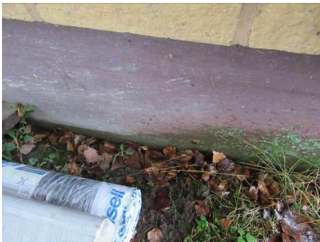
Kuva 6.16 Rakennuksen sokkelissa kosteuden aiheuttamaa sammaloitumista.
