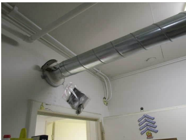
Kuva 6.63 Käytävän ilmanvaihdon päätelaite.
