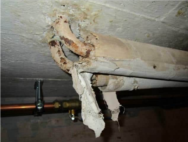
Kuva 6.73 Vaurioitunut alkuperäinen lämmöneristys, joka saattaa sisältää asbestia.
