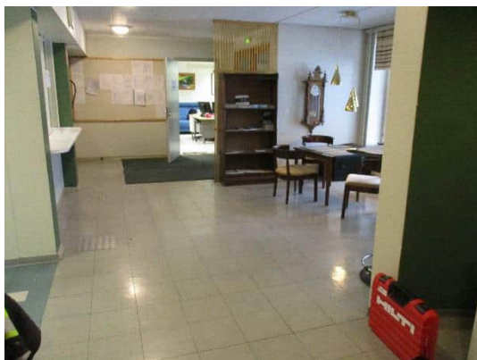
Kuva 63. Lattiassa musta asbestipitoinen liima.
