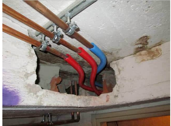
Kuva 6.65 Rakennuksessa on jossain vaiheessa uusittu käyttövesiputkia
