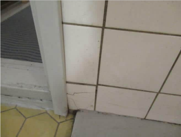
Kuva 6.42 Osa pesuhuoneen seinälaatoista on rikkiäisiä.
