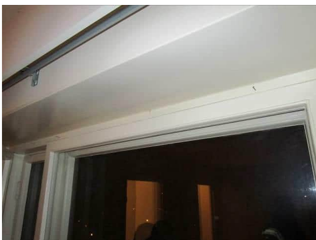
Kuva 6.78 Ikkunoissa ei ollut havaittavissa korvausilmaventtiileitä
