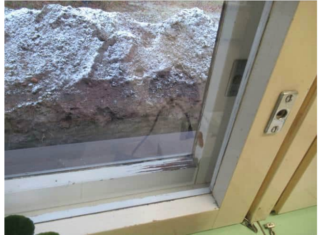
Kuva 6.23 Ikkunoissa on havaittavissa kosteuden aiheuttamia jälkiä.
