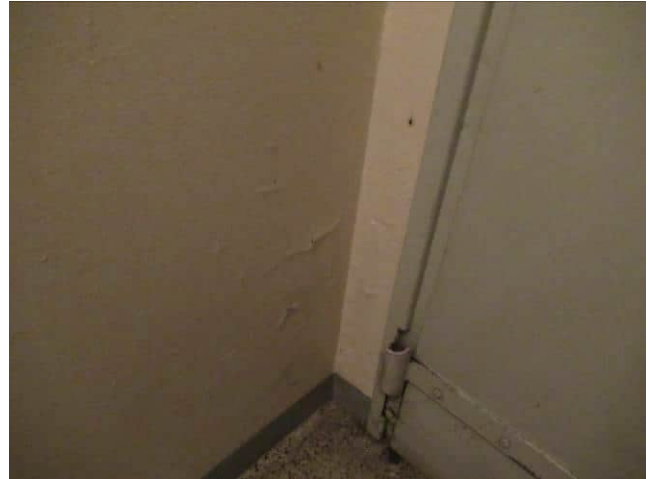
Kuva 6.43 Kellarikerroksen porrashuoneen seinän maalipinnassa on havaittavissa kosteuden aiheuttamia jälkiä.
