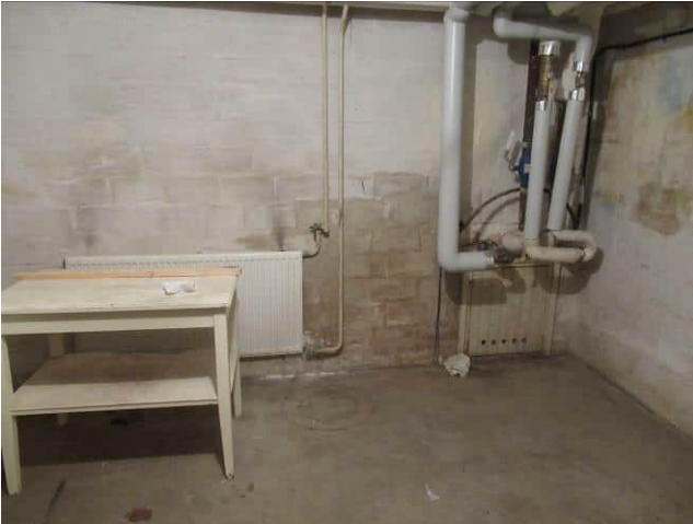
Kuva 6.16 Kellarin seinissä on havaittavissa viitteitä kosteudesta.
