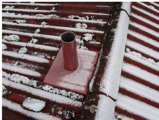
Kuva 6.56 Eristämätön tuuletusviemäriin pää.
