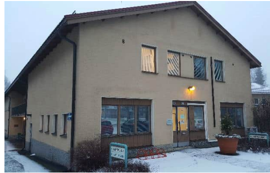
Kuva 36. Julkisivussa näkyvillä lämpövuotoja.
