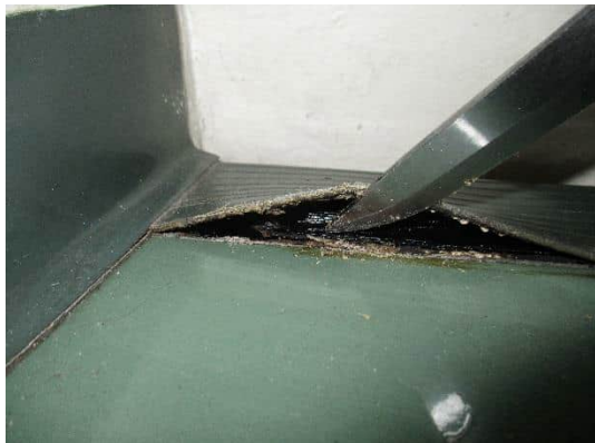
Kuva 61. Portaiden maton alla asbestipitoinen musta liima.
