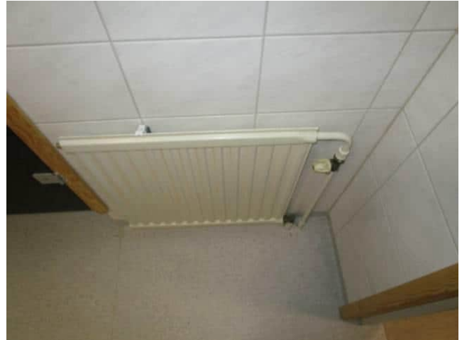
Kuva 6.42 Kylpyhuoneen lämmityspatteri ja patteriventtiili
