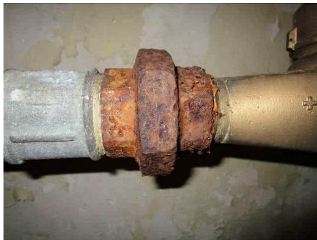
Kuva 6.63 Vesimittarin ruostunut liitos.
