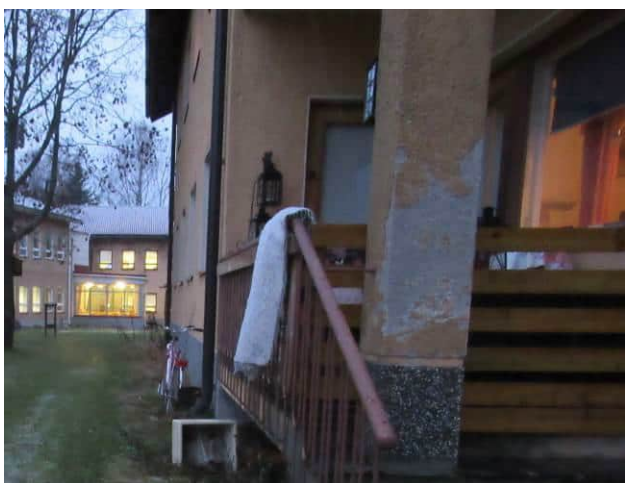
Kuva 6.18 Parvekkeen pilarin rappaus on vaurioitunut.
