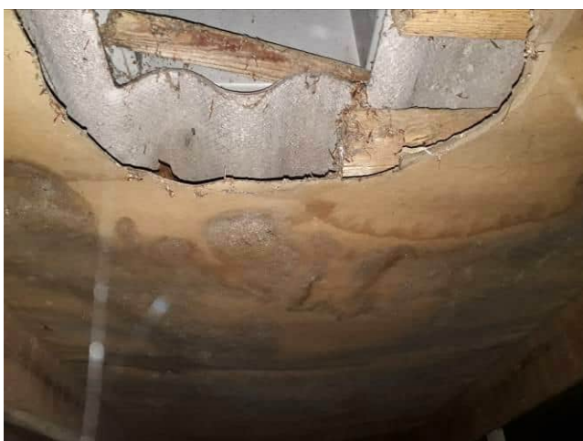
Kuva 6.31 Läpiviennit eivät ole tiiviitä.
