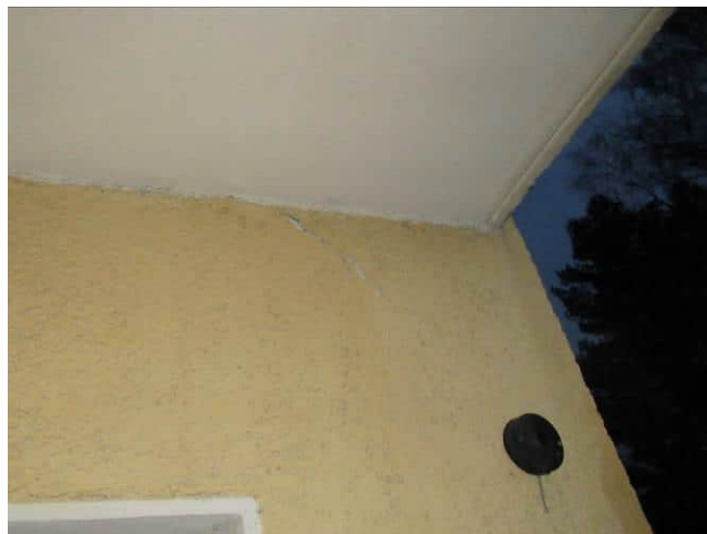
Kuva 6.19 parvekkeen seinässä vaurioita rappauspinnassa.
