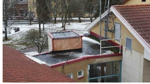
Kuva 27. Lammikoitunutta vettä laajennusosan katolla (alue ei kuulunut kuntotutkimukseen).
