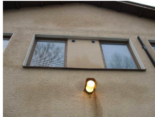
Kuva 60. Näyte julkisivurappauksesta (ASB10), sisältää asbestia. Eteläpäädyn yläkerran ikkunoiden välissä oleva levy on asbestipitoinen.
