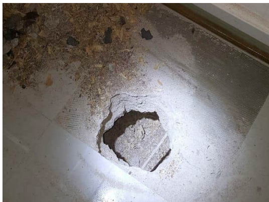
Kuva 71. Välipohjaan tehdystä rakennauksesta havaittiin välipohjan tervapaperi (näyte PAH1), joka sisältää PAH-yhdisteitä yli raja-arvon.
