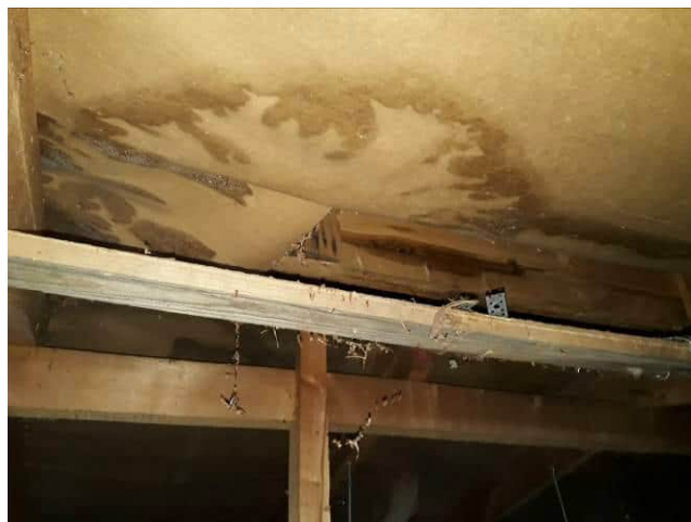
Kuva 6.30 Panssarialuskatteessa on näkyvissä vesijälkiä.
