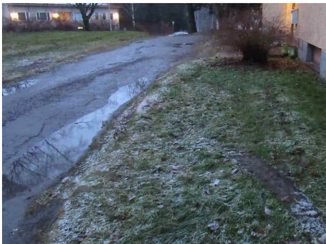
Kuva 6.6 Liikennealueet ovat sorapintaisia ja paikoin huonokuntoisia.
