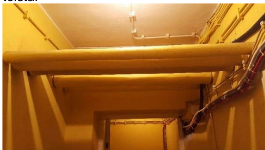
Kuva 57. Putkieristeistä otetuista näytteissä ei ollut asbestia, mutta eristeet suositellaan käsiteltäväksi asbestipitoisena.
