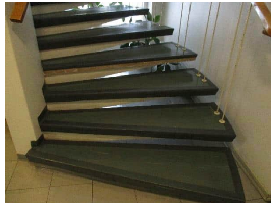
Kuva 62. Portaiden maton alla asbestipitoinen musta liima.
