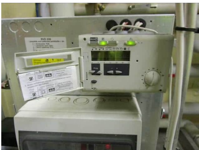
Kuva 6.50 Lämmönjakokeskuksen ohjausyksikkö RVD-235
