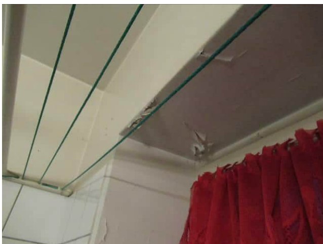
Kuva 6.46 Pesuhuoneen ikkunasyvennyksen maali hilseilee.
