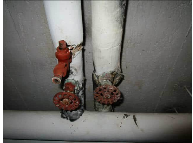
Kuva 6.57 Hyvin huonossa kunnossa olevia venttiileitä
