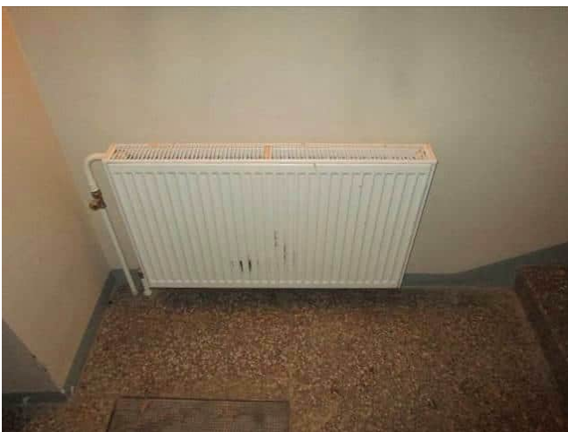
Kuva 6.60 Käytävän hyväkuntoinen lämmityspatteri
