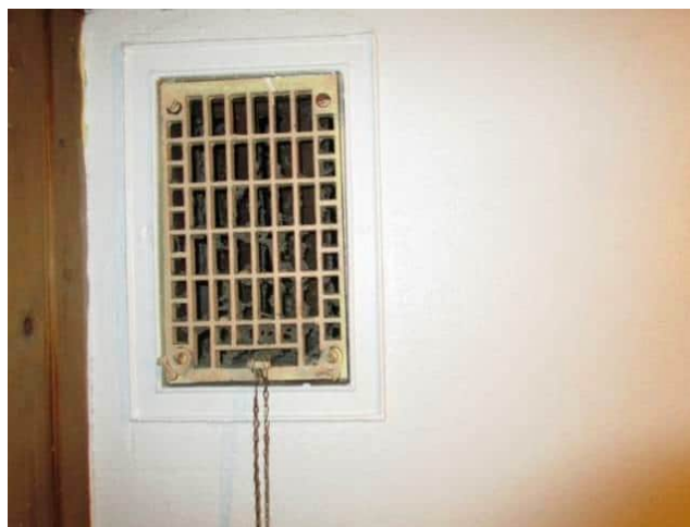
Kuva 6.75 Alkuperäinen poistoilmaventtiili hormiin asennettuna
