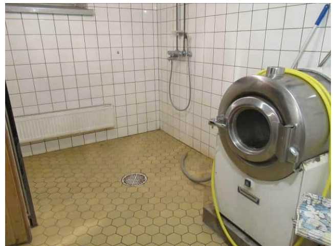
Kuva 6.41 Saunatilan pintamateriaalit ovat ikääntyneitä.
