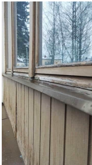
Kuva 20. Lounasjulkisivun ikkunan pellitykset kaatoivat sisäänpäin.
