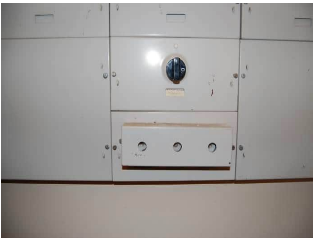
Kuva 6.65 Pääsulakkeet sekä pääkytkin
