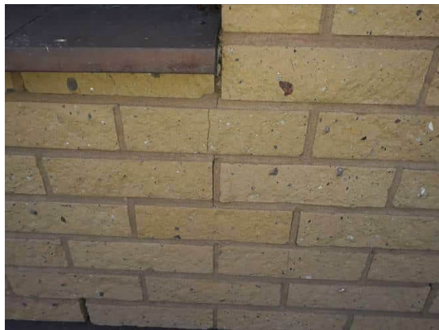
Kuva 6.19 Ikkunan alareunassa on yksittäinen tiili lohjennut.
