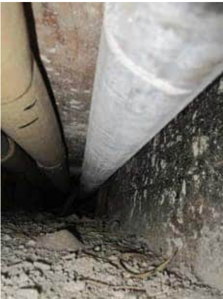
Kuva 5: Putkikanaalin avauspiste A: Kanaalin pohjalla rakennusjätettä
