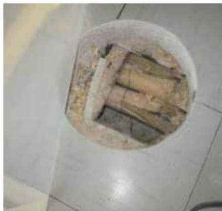
Kuva 4: Putkikanaalin päällystä avattuna pisteessä A. Kanaalissa voimakas haju
