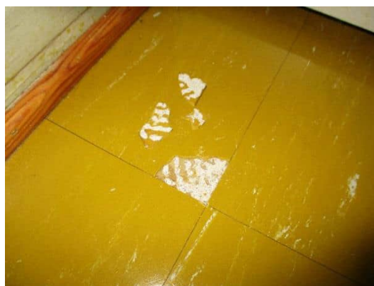
Kuva 46. Lattioiden Finnflex-laatat sisältävät asbestia.
