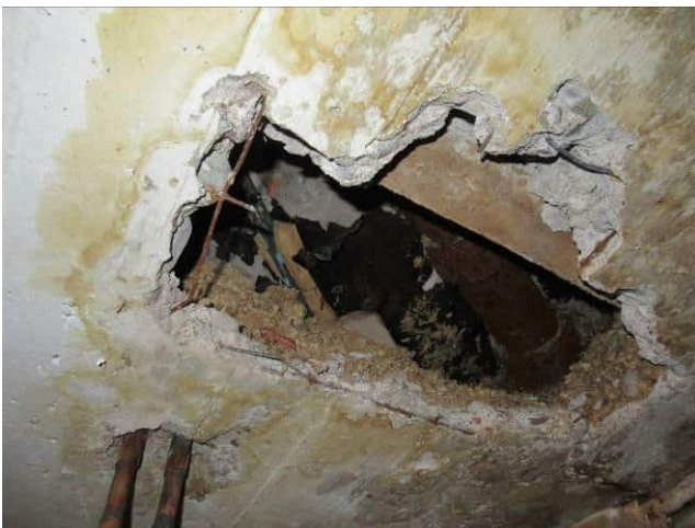
Kuva 6.40 Viemärivuoto vaurioittaa ainakin välipohjan eristeitä.
