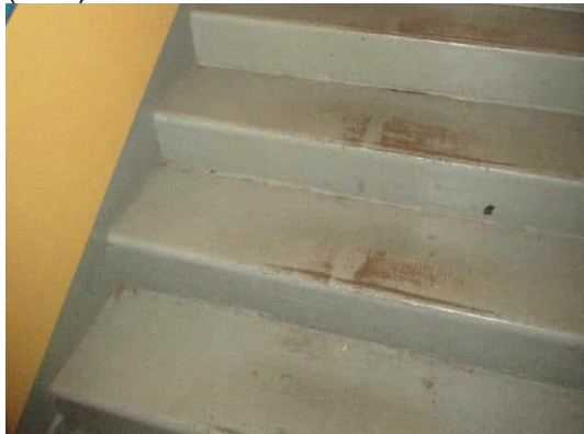
Kuva 85. Portaiden ja kellarin lattian maali sisältää sinkkiä (RM3).
