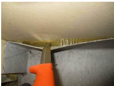
Kuva 70. Muovimaton takana kirkasta liimaa (ei sisällä asbestia).
