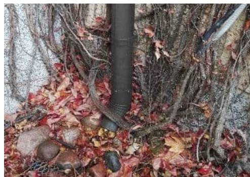
Kuva 34. Syöksytorven pää tukossa lehdistä.
