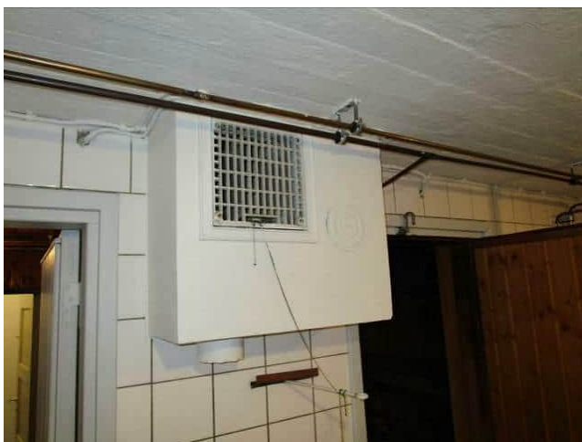
Kuva 6.74 Alkuperäinen poistoilmaventtiili hormiin asennettuna.
