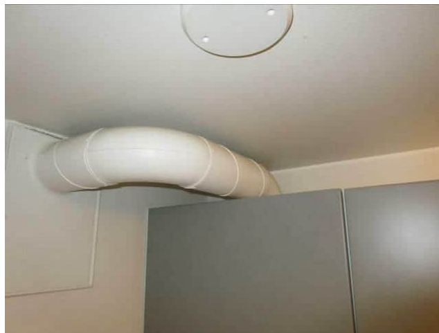
Kuva 6.77 Liesituuletin on kytketty hormiin ilmanvaihtokanavalla
