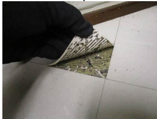
Kuva 56. Lattian musta liima sisältää asbestia.
