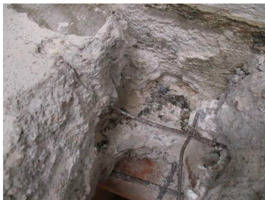
Kuva 74. Näyte välipohjan sivelestä (PAH4), ei sisällä PAH-yhdisteitä yli haitallisen määrän raja-arvon.
