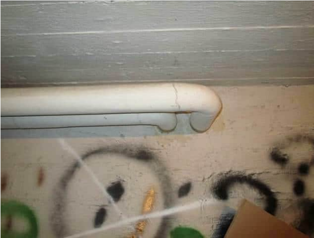
Kuva 6.52 Alkuperäiset eristetyt runkojohdot
