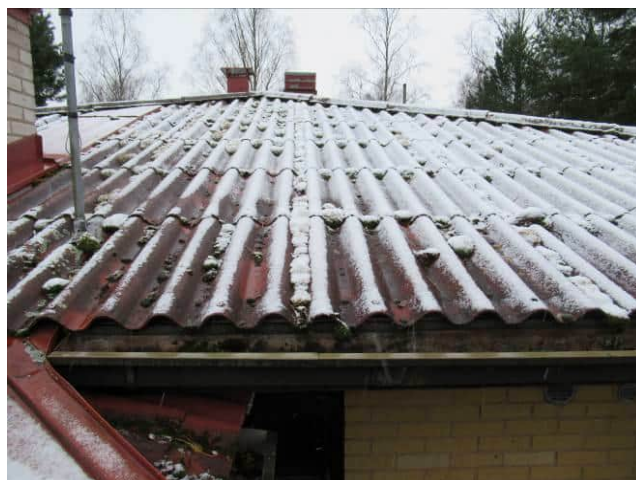
Kuva 6.35 Tiilikate on sammaloitunut.
