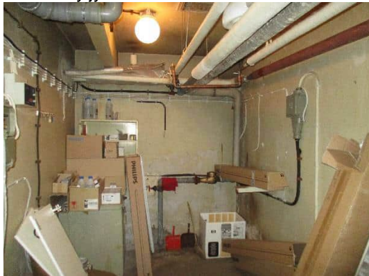
Kuva 83. Seinä- ja kattomaali sisältää sinkkiä (RM1).
