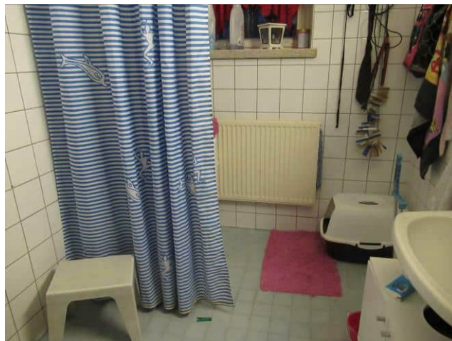
Kuva 6.45 Toisen asunnon pesuhuoneen laatoitukset on uusittu jossain vaiheessa.
