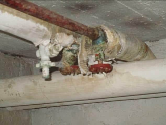
Kuva 6.56 Hyvin huonossa kunnossa olevia venttiileitä
