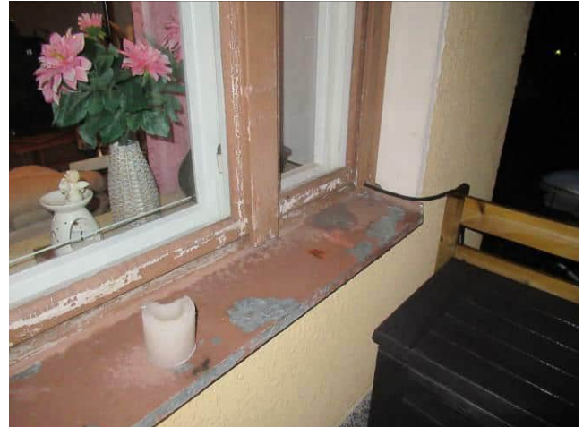
Kuva 6.21 Ikkunapellitykset ja ulomman ikkunan puitteet huonokuntoisia
