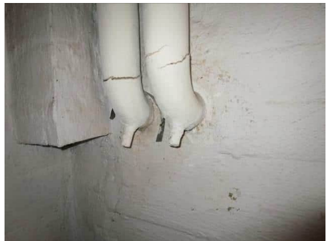
Kuva 6.72 Alkuperäiset eristykset saattavat sisältää asbestia.
