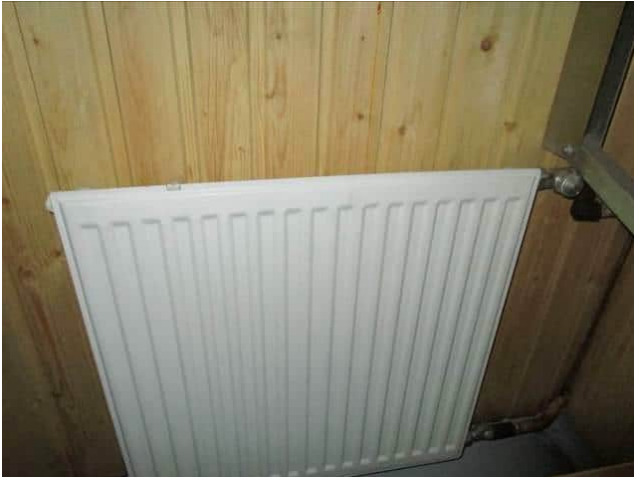
Kuva 6.58 Hyväkuntoinen patteri sekä käsinsäädettävä patteriventtiili
