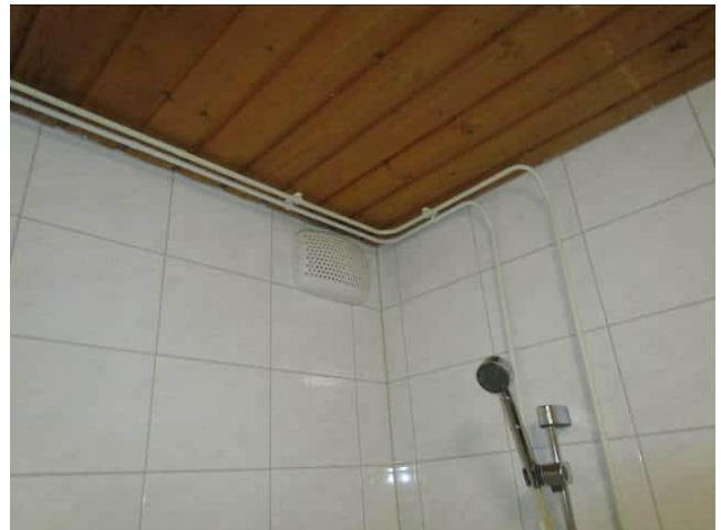
Kuva 6.46 Pinta-asennettua alkuperäistä kupariputkea saunatilassa
