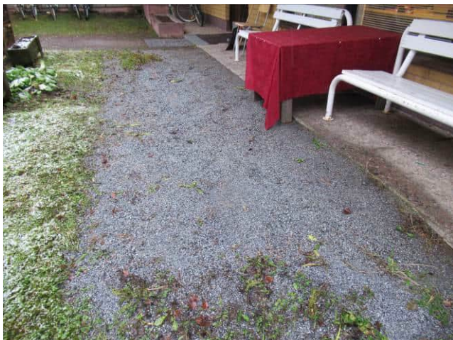
Kuva 6.1 Rakennus sijaitsee tasamaalla, maanpinnan kallistus pois rakennuksesta on paikoin olematon.
