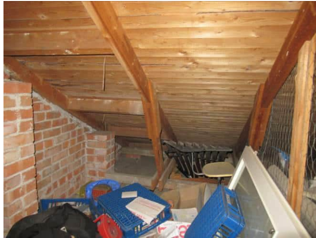
Kuva 6.32 Yläpohjatilassa säilytettävät tavarat aiheuttavat paloturvallisuusriskin.
