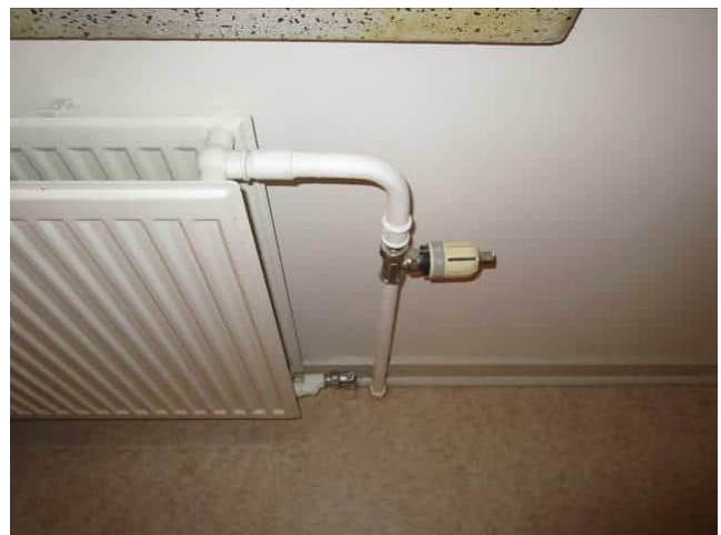
Kuva 6.61 Asunnon lämmityspatteri, kytkentäjohto ja tyydyttävän kuntoinen termostaattinen patteriventtiili.
