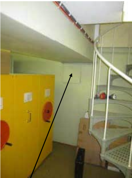
Kuva 1: Kellariarkistossa putkikanaalin ja viemäriyhteiden tarkastusluukku. Peitekilven avauksen yhteydessä kanaalista tulvahtaa voimakas maakellarimainen haju
