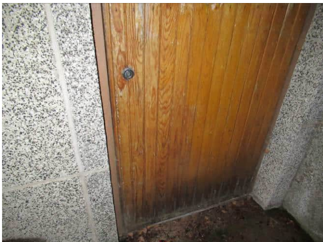
Kuva 6.23 Kellarin oven alareuna on vaurioitunut.
