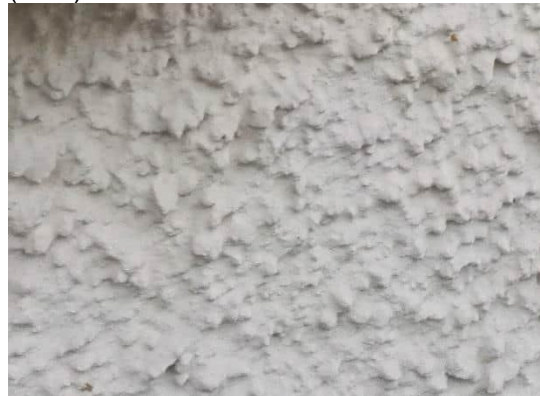
Kuva 86. Julkisivumaali sisältää sinkkiä (RM6).
