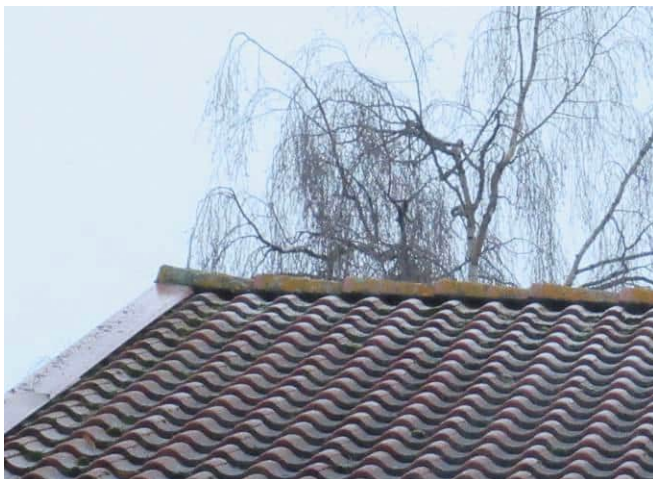
Kuva 6.33 Tiilissä on havaittavissa jonkun verran sammaloitumista.
