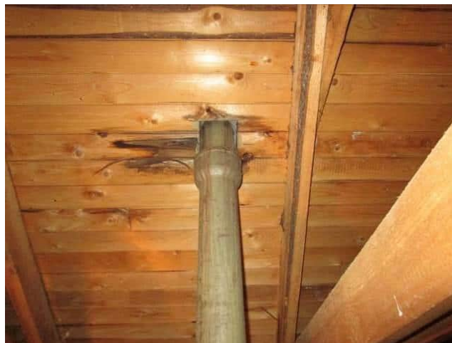
Kuva 6.67 Eristämätön tuuletusviemäri ullakolla
