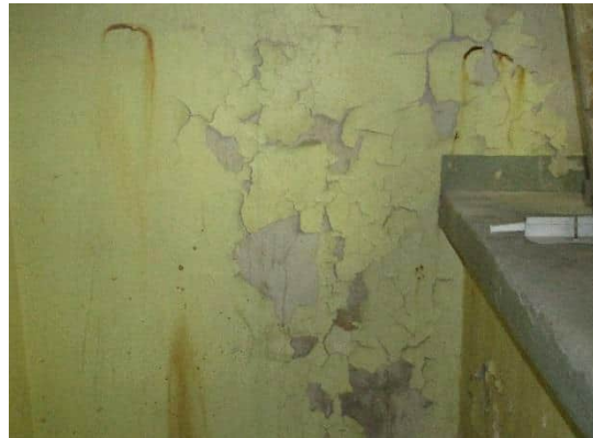
Kuva 84. Seinä- ja kattomaali sisältää sinkkiä (RM2).
