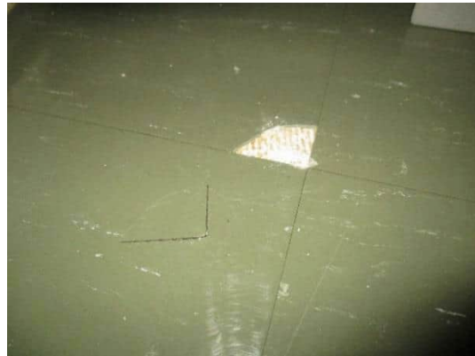
Kuva 48. Lattioiden Finnflex-laatat sisältävät asbestia.
