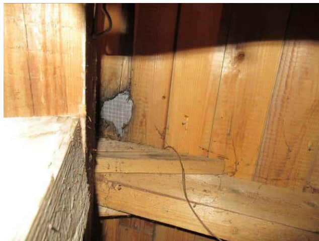
Kuva 6.34 Vesikaton aluslaudoituksen vauriokohdasta on havaittavissa, että tiilikatteen alla on aluskate.
