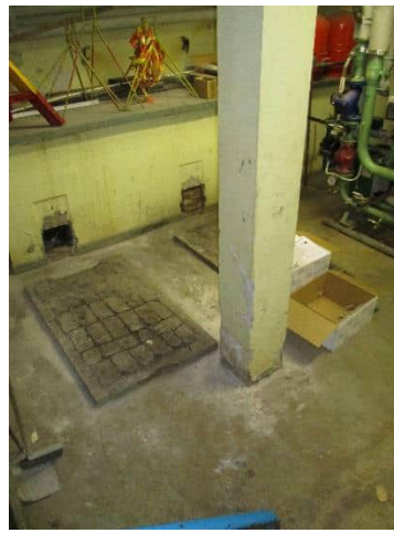
Kuva 68. Vanhojen suunnitelmien mukaan lattian kattilakorokkeissa on sisällä asbestilevyä.
