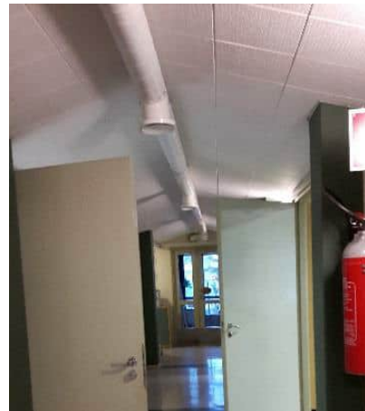
Kuva 90. Käytävälle tuotu korvausilmakanava.
