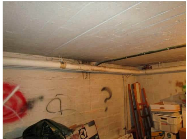
Kuva 6.55 Kellaritilassa runkojohdot kulkevat leikkaustason yläpuolella
