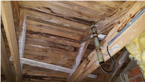
Kuva 24. Läpiviennin kohdalla ollut vesivuotoa.
