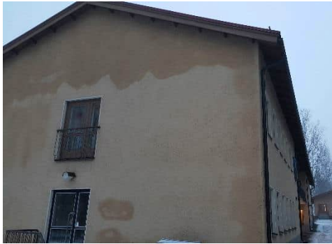
Kuva 35. Julkisivussa selkeästi näkyvissä lämpövuotoja.
