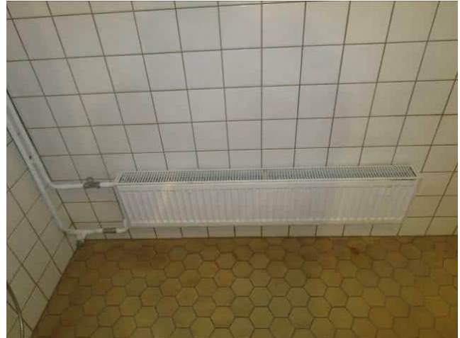
Kuva 6.59 Saunatiloissa oleva hyväkuntoinen lämmityspatteri
