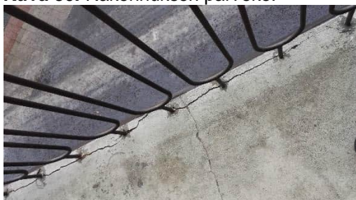
Kuva 32. Parvekkeessa halkeamat rataakiskojen kohdalla sekä parvekkeen etureunassa.
