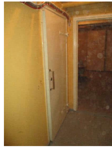
Kuva 69. Kellarin palo-ovet sisältävät asbestia.
