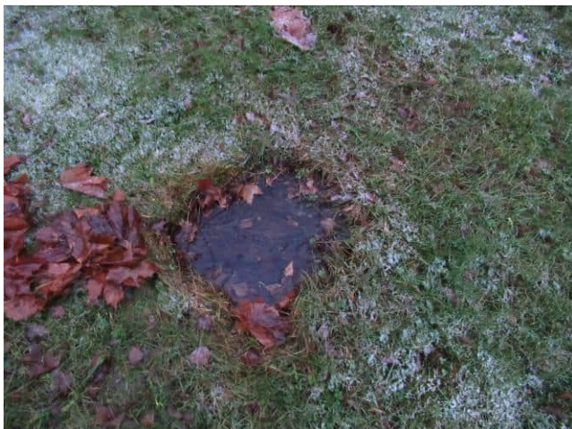
Kuva 6.3 Todennäköisesti salaojien tarkastuskai- vo.
