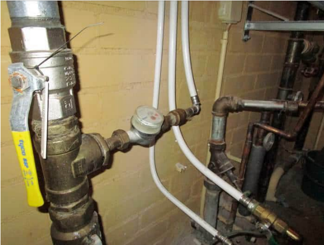
Kuva 6.43 Päävesimittari ja sulkuventtiilit varastuhuoneessa
