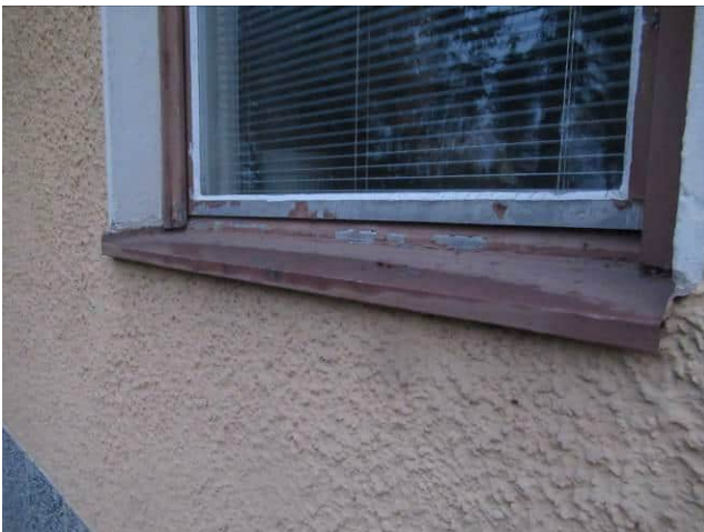
Kuva 6.22 Ikkunapellitysten kaato on paikoin riittämätön.
