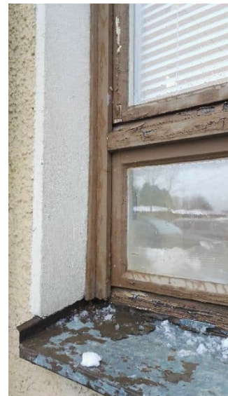
Kuva 21. Maalin hilseilyä ikkunoissa ja pellityksissä.
