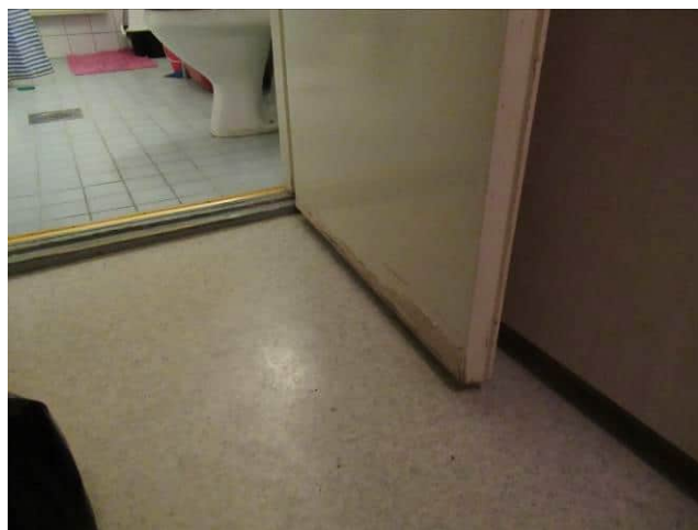
Kuva 6.47 Pesuhuoneen oven alareuna on vaurioitunut.
