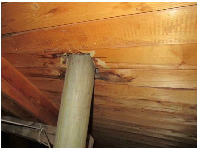
Kuva 6.29 Läpiviennin kohdalla vesijälkiä.
