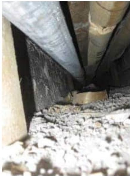
Kuva 6: Putkikanaalin avauspiste A: Kanaalin pohjalla rakennusjätettä
