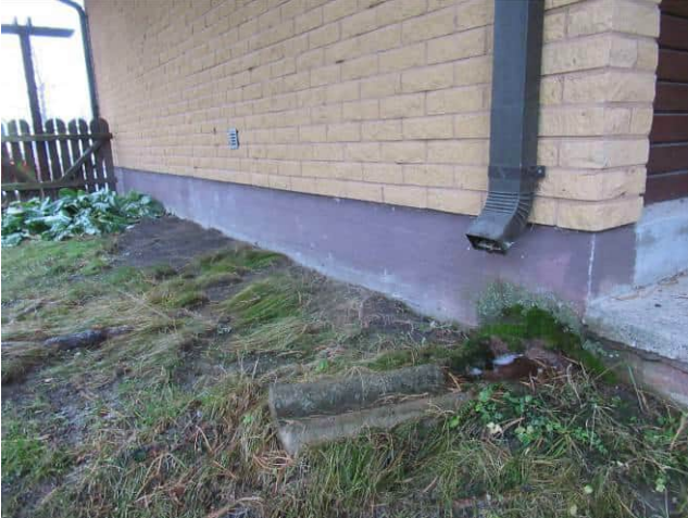
Kuva 6.7 Kasvillisuus ulottuu seinän vierustalle asti.
