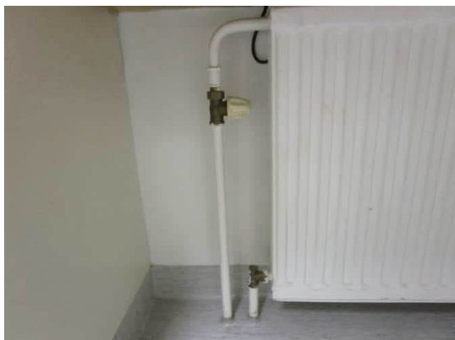
Kuva 6.39 Kytkentäjohto patterille ja iäkäs patteriventtiili ja säätölaite
