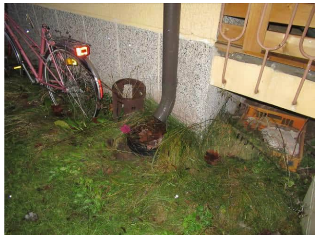
Kuva 6.2 Takapihan puolella kattovedet ohjataan sadevesikaivoon.
