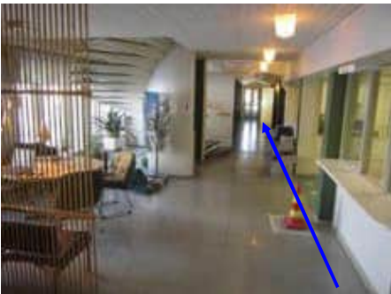
Kuva 11: Yleiskuva aulatilasta, putkikanaalin sijainti
