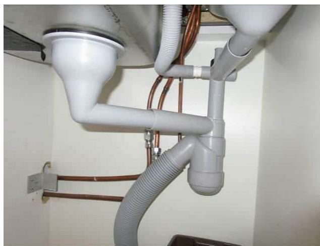
Kuva 6.69 Keittiön pesualtaan vesilukko
