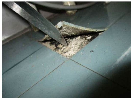
Kuva 52. Lattian musta liima sisältää asbestia.
