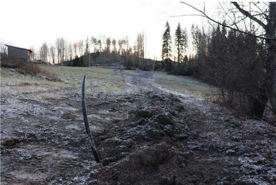
Kuva 43. Kukkasmaan talon eteläpuolella oli asennettu maakaapeli.
