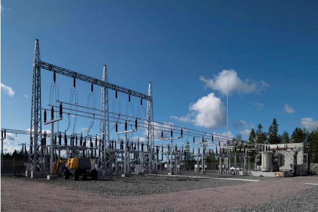
Kuva 2-4- Esimerkki tuulivoimahankkeen sähköasemasta. © Ilmatar Energy Oy.
