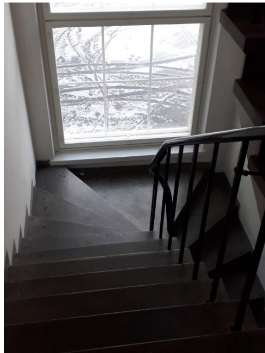
Pikkuporras. Huom "alkuperäisen mallin mukaan" uusitut ikkunat, joissa puutejako on korvattu ulkopuolen ristikolla.
