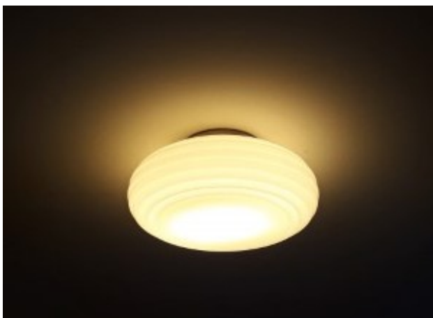
Tuulikaapin ja porraskäytävän valaisin, todennäköisesti alkuperäinen.
